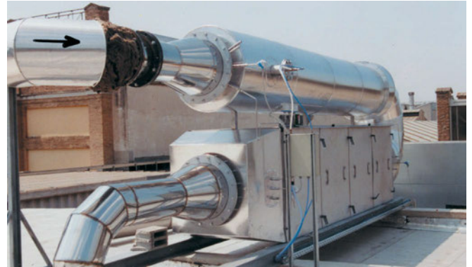
DeNO x -Katalysatoranlage für Dieselmotor 14.300 m 3 /h
