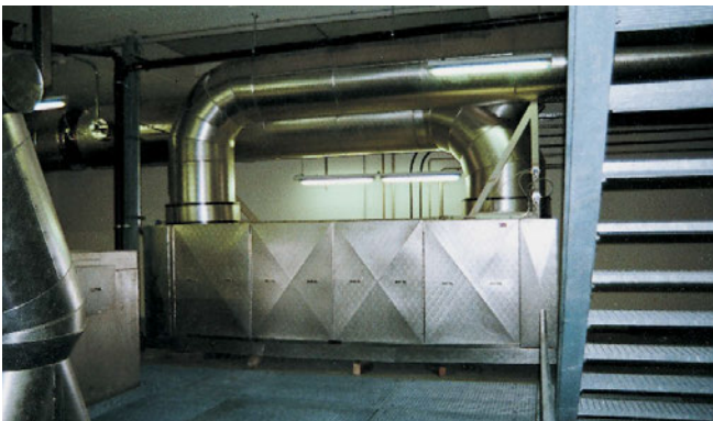
Katalysatoranlage zur Reduktion von NO x , CO, CmHn nach Sprengstoffverbrennung 28.500 m 3 /h
