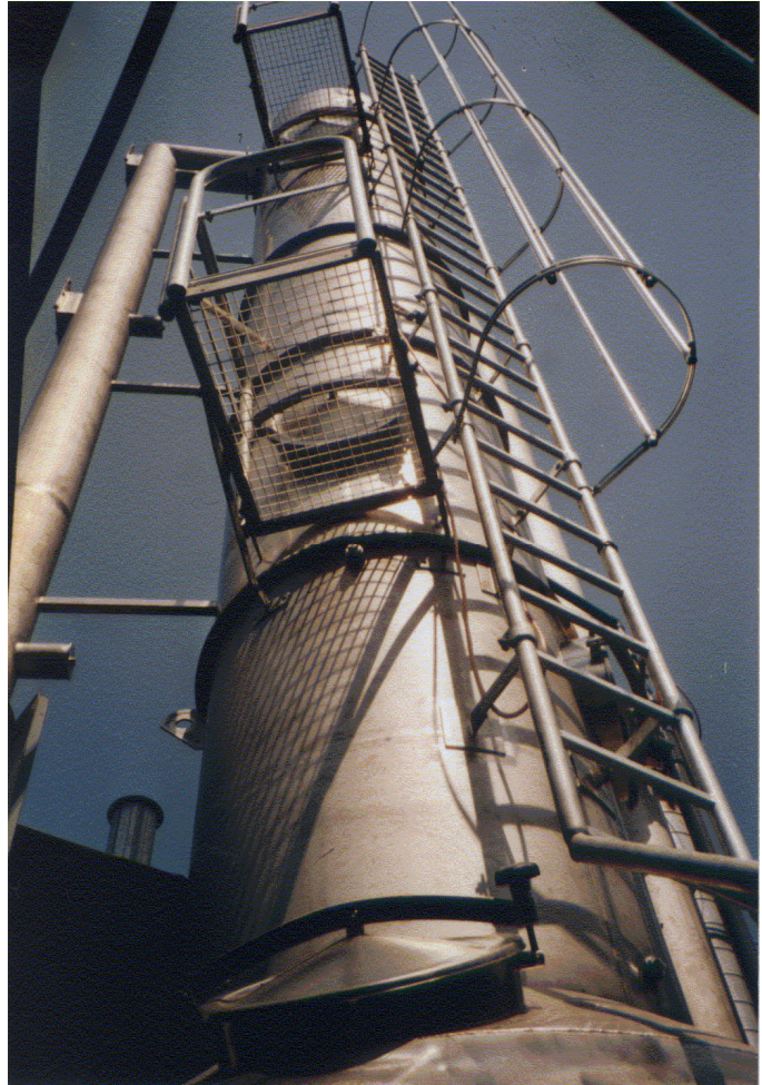
Rauchgasreinigungsanlage für 3.000 m 3 /h Kalt- und Heißrauch
